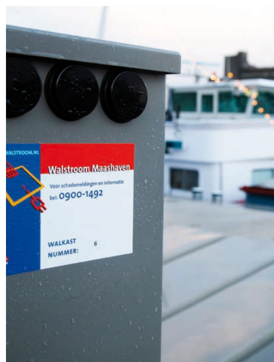
Havenbedrijf Rotterdam: project Walstroom
